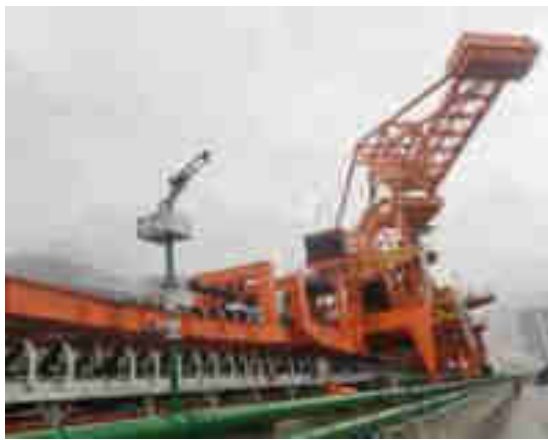
防尘喷淋系统
