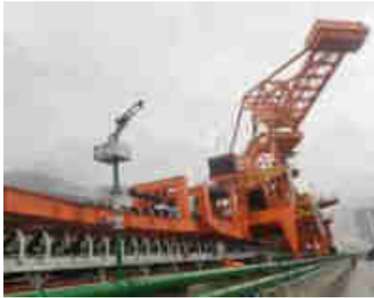
防尘喷淋系统
